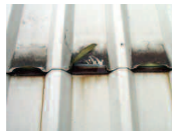
Alternativ lærpreget overflate på tak med vanlig varmforsinket stålunderlag etter 7 år.
